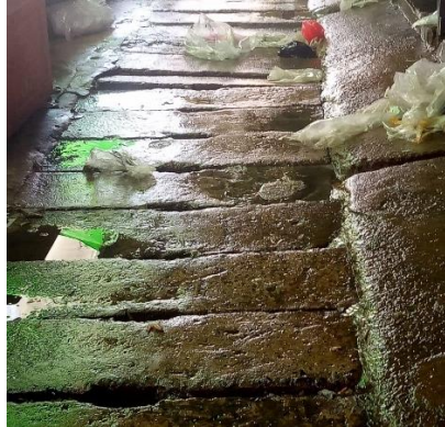
Gambar 4.14 Saluran Drainase Tertutup
