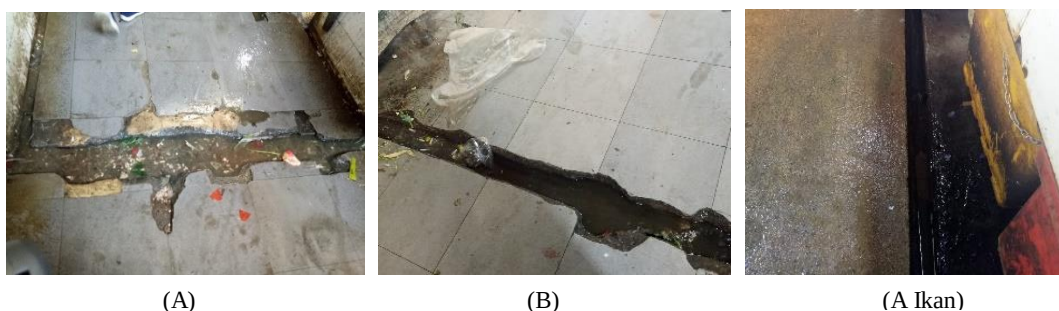
Gambar 4.13 Saluran Drainase di Pasar Flamboyan
