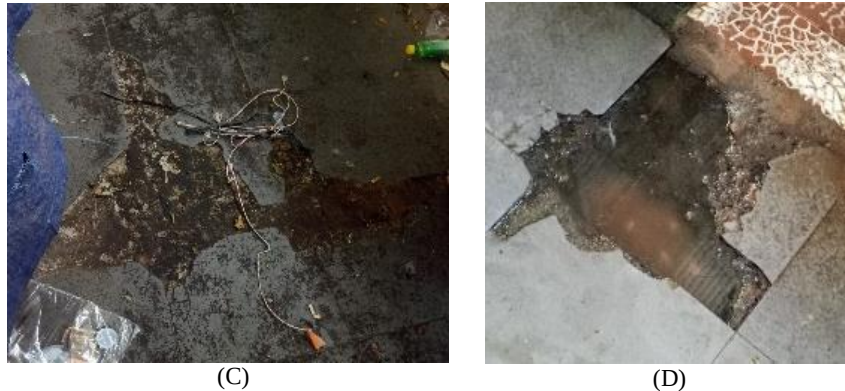
Gambar 4.3 Lantai Retak di Pasar Flamboyan
