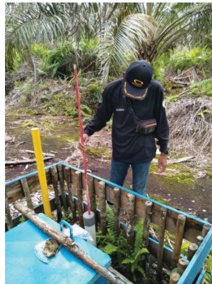
Gambar 10. Alat Pengukur Tinggi Level Air (Piezometer)
