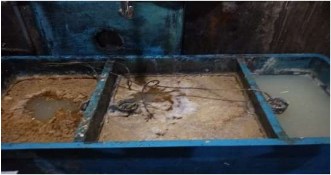
Insatalasi Pengelola Air Limbah (IPAL) Rumah Makan Katsuya di Jl.Purnama 1
