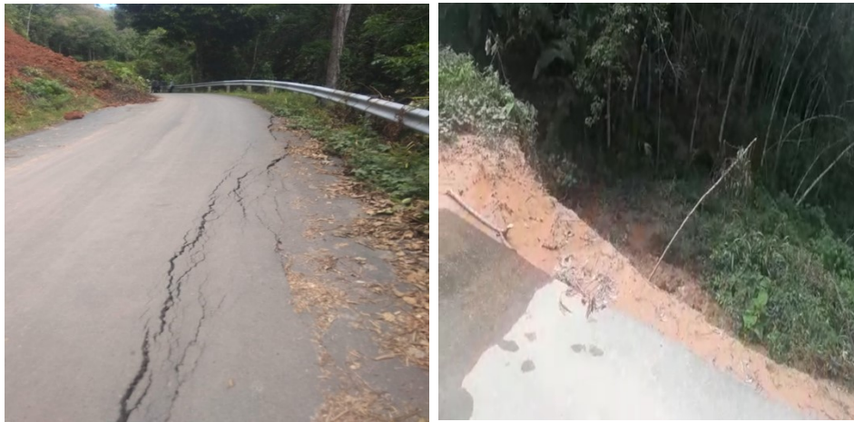
Gambar 1.1. Retakan pada ruas Jalan simpang pintas – Sayan yang terjadi akibat longsor pada lereng yang berada dibawah permukaan jalan.
