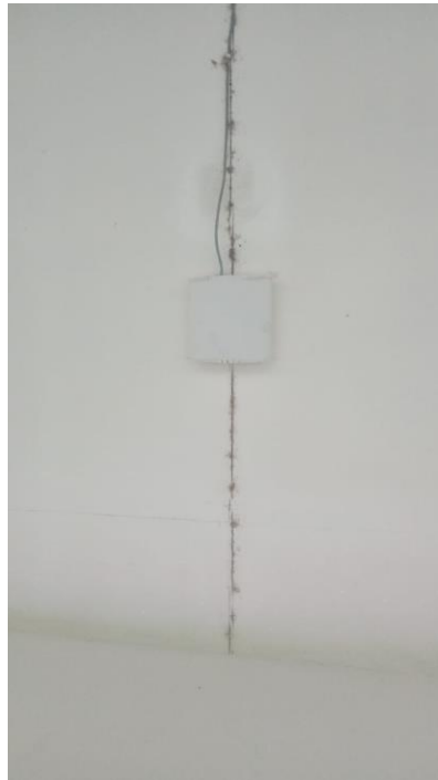
Gambar 3.13 Area D04 – D13 Access Point 1
