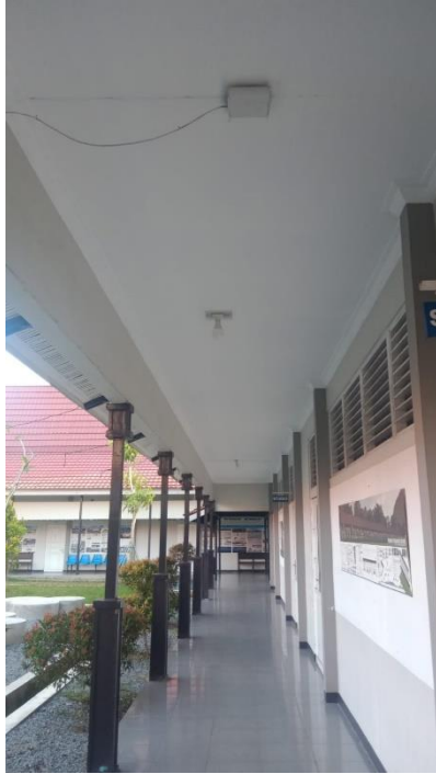
Gambar 3.16 Area D04 – D13 Access Point 4
