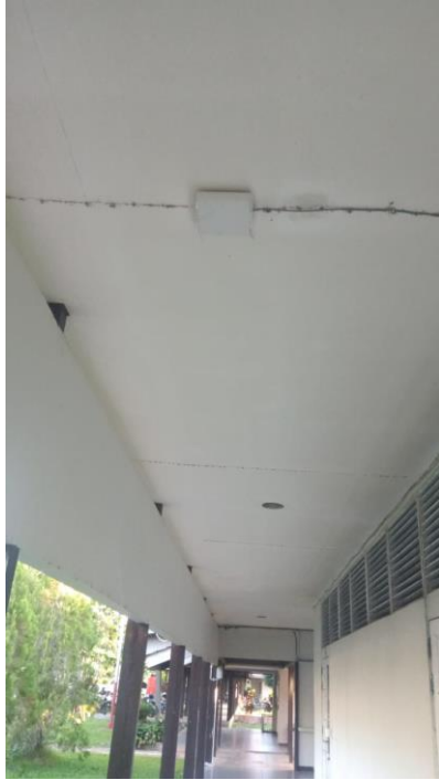
Gambar 3.14 Area D04 – D13 Access Point 2
