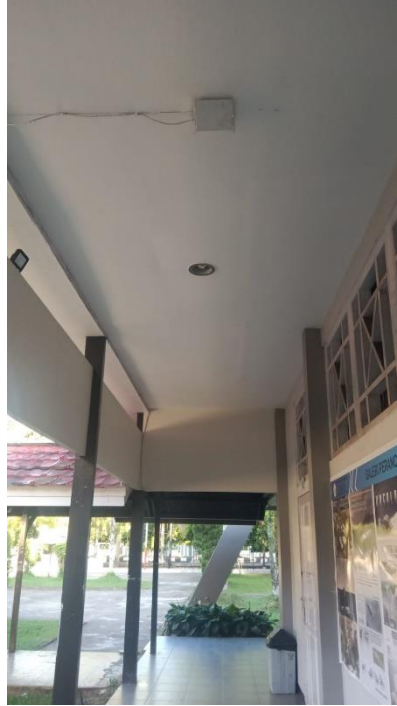
Gambar 3.17 Area D04 – D13 Access Point 5
