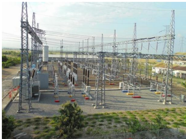
Gambar 2.1. Gardu Induk 150 kV.
