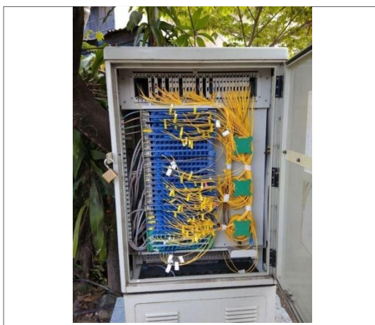
Gambar 2. 6 Optical Distribution Cabinet (ODC)
