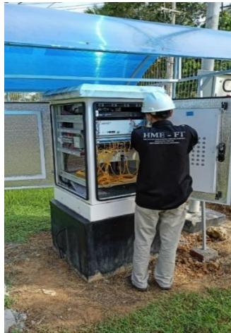
Gambar 4.4 Perapihan Kabel Patchcord Bending (Samarinda)
