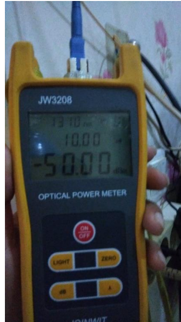
Gambar B.3 Deteksi Redaman Kabel Yang LOSS di Samarinda
